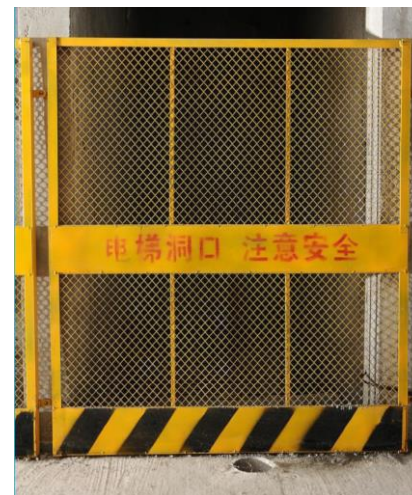
电梯井洞口防护门(二)
