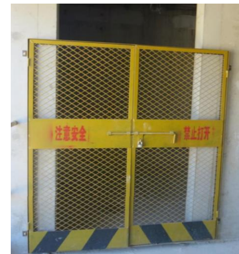
电梯井洞口防护门(三)
