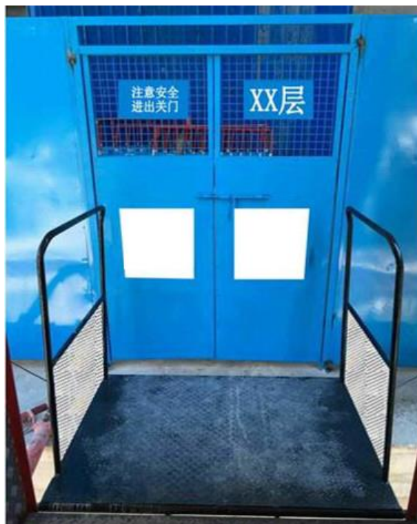
电梯防护门实景图
